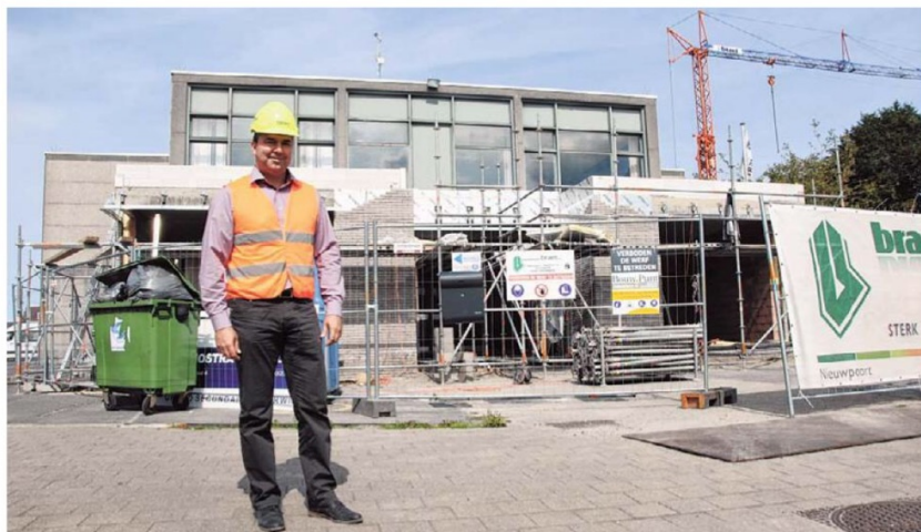
Stefaan Vanhollebeke voor de nieuwe gevel van Spes Nostra. De school is een grote bouwwerf. “Maar we zetten absoluut 200% in op de veiligheid van de kinderen”, zegt de directeur. (Foto BC)
